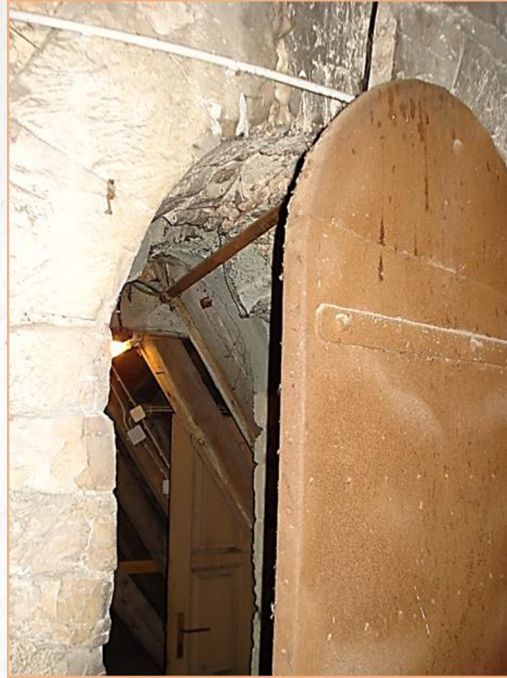
Die höchste Brandgefahr in einer historischen Kirche: unwirksame Abschottungen zwischen Dachboden und Kirchturm.
