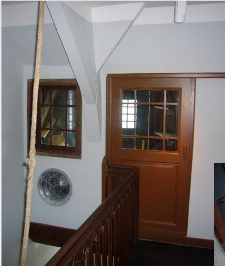
Brandgasventilator im Treppenraum
