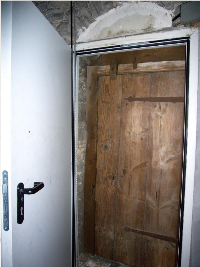
T-30-Feuerschutztür vor einer historischen Holztür
