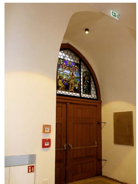
(9) Ausgang Westportal: Hinweisschild, Druckknopfmelder, Steuerung Rauchabzug, Feuerlöscher
