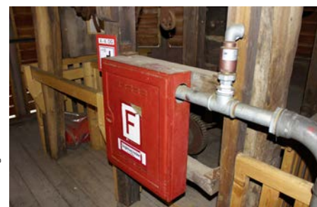
(4) Löschwasserleitung im Nordturm
