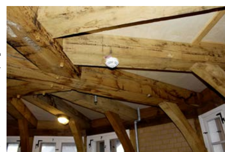
(3) Sprühwasser-Löschanlage im Nordturm
